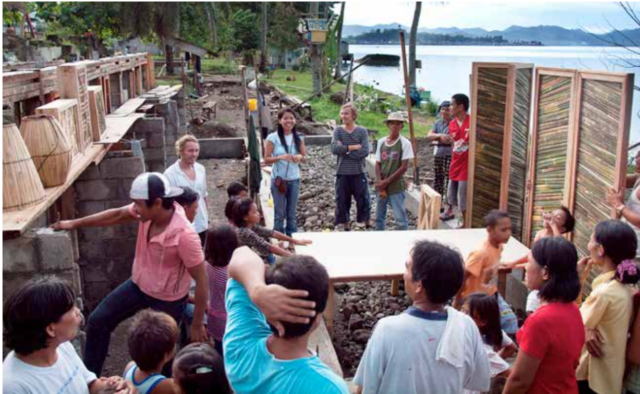
Bygging av bibliotek for Streetlight i Tacloban på Fillipinene. Arkitektstudenter fra NTNU bygget sammen med lokalbefolkningen. Biblioteket ble rasert under orkanen i 2013, men skal bygges opp igjen med hjelp av og deltakelse fra NTNU.
