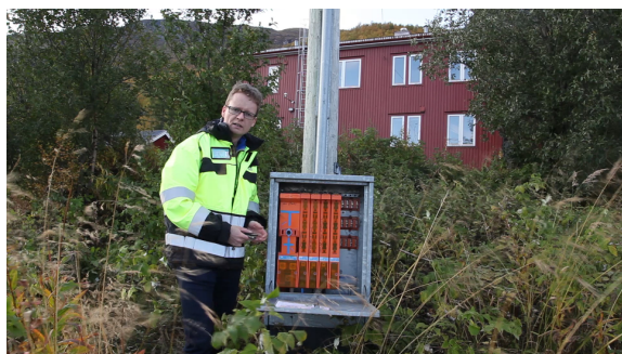
Fig. 1. Videoopptak ved kabelskap
