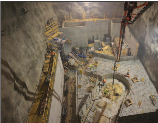
(i) The new 225 MW powerhouse at Røssåga.
