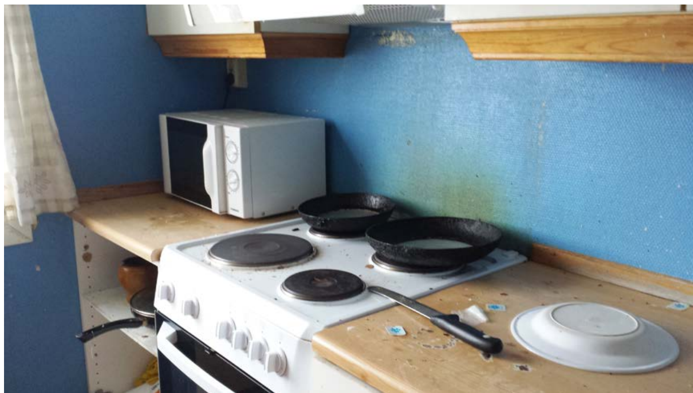
Eksempel på bygningsmessig slitasje på norske asylmottak. Example of the wear and tear common to many asylum seekers' reception centres in Norway. Foto: Ragne Øvre Thorshaug
