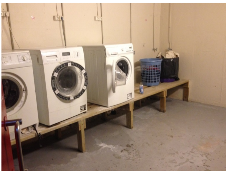
Ødelagte vaskemaskiner og «alltid vann på gulvet». Foto: SINTEF Byggforsk
